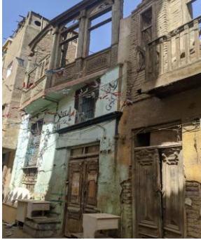
شكل (20) تهدم وإهمال لبعض المباني التاريخية بالمنطقة
